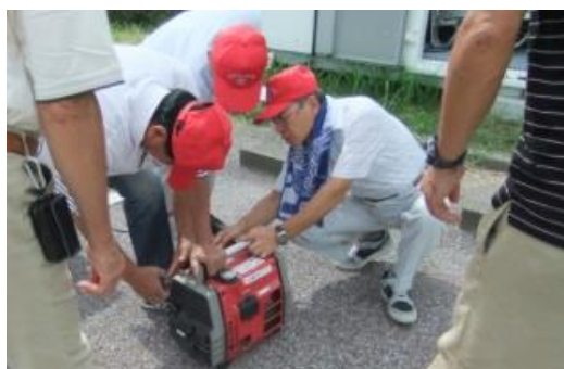
発電機の始動・停止
