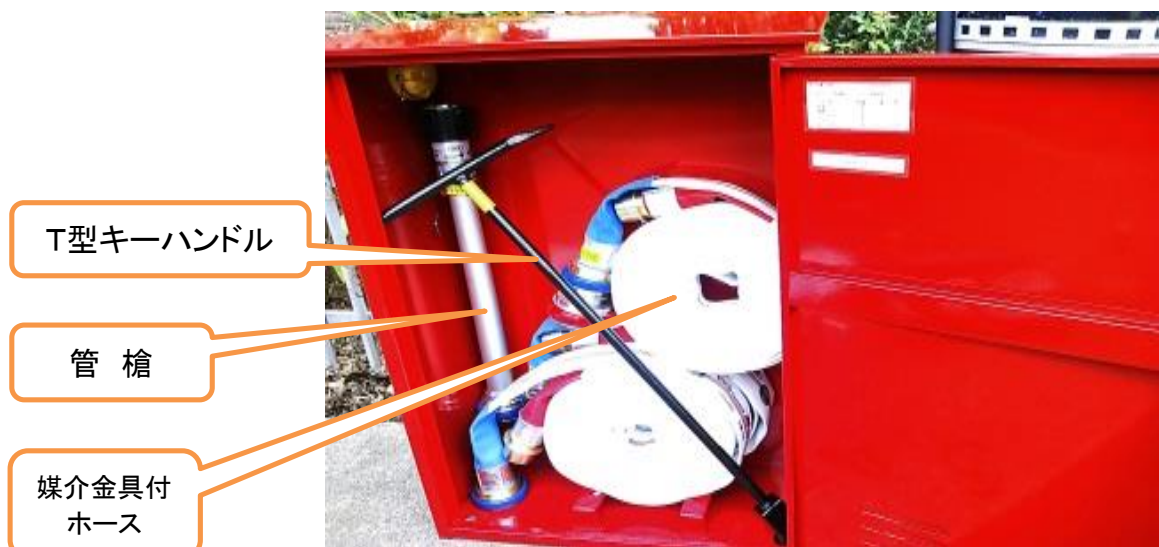
ホース格納箱内部
